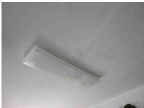
Obr.č.15 Prvky systému umelého osvetlenia
